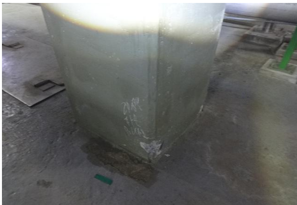
외부 기둥 파손 (A=0.1m×0.2m)
