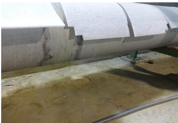
외부 바닥 도장들뜸 (A=0.5m×0.5m)
