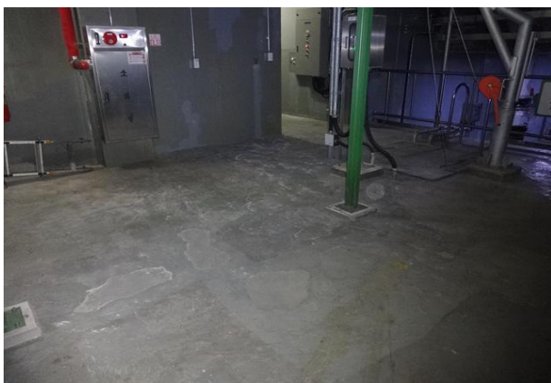
외부 바닥 도장들뜸 (A=5.0m×5.0m)
