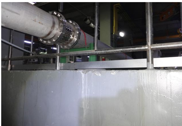
외부 벽체 콘크리트 박락 (A=0.1m×0.1m×3EA)
