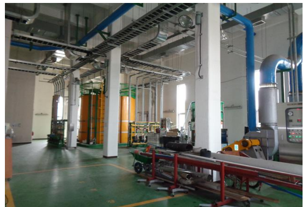
내부 약품 및 탈취기실 전경
