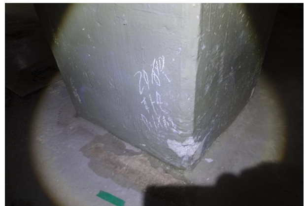
외부 기둥 파손 (A=0.1m×0.2m)
