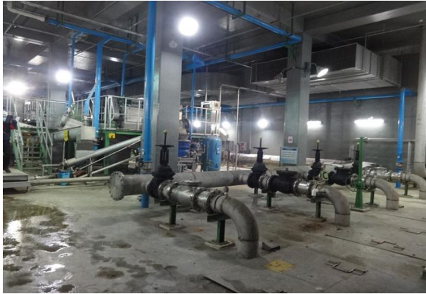
유량조정 및 유입펌프장 전경
