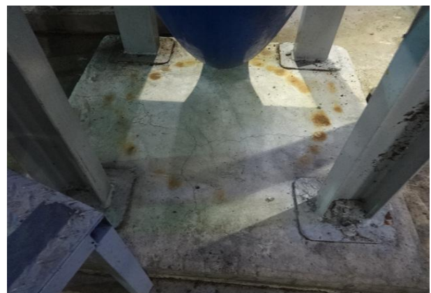
외부 바닥 설비 받침콘크리트 망상균열 (A=1.0m×1.0m)
