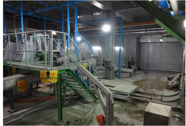
침사 및 협잡물 처리시설 전경
