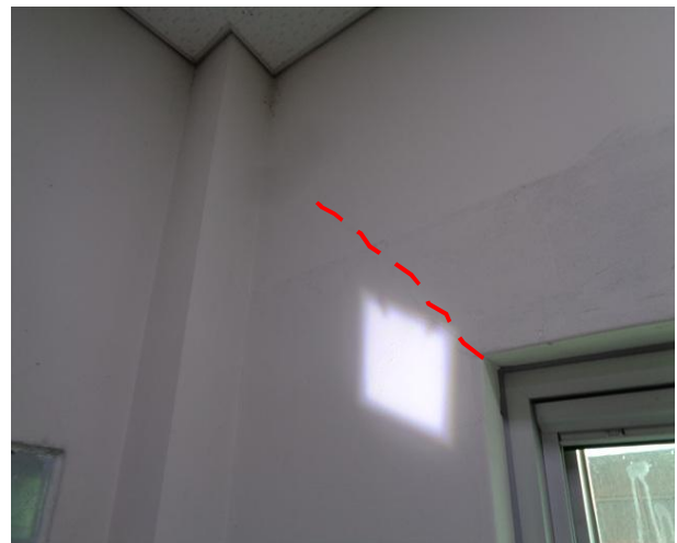
내부 벽체 마감 균열 (CW=0.2mm, L=1.0m)
