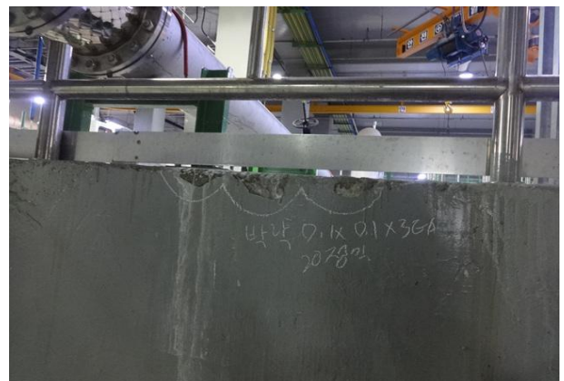
외부 벽체 콘크리트 박락 (A=0.1m×0.1m×3EA)
